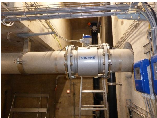
MiD Pumpwerk Auhof
