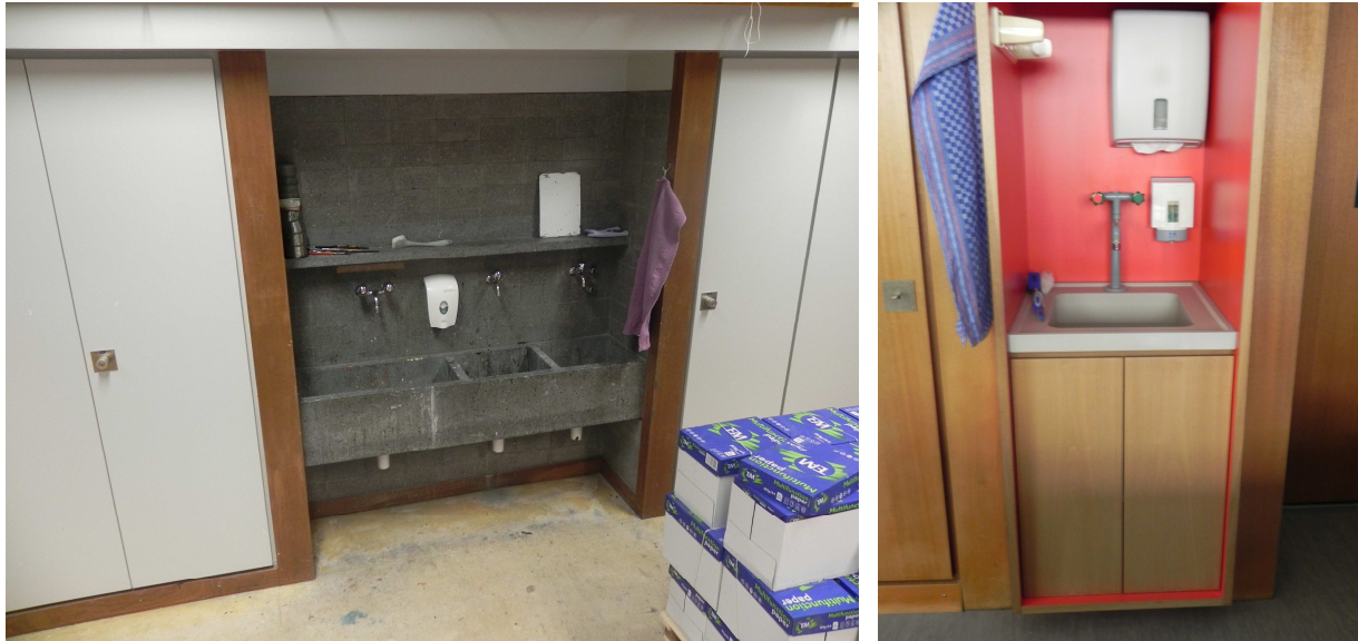
Abbildung 1, Alte Kunststoffbecken, in Schrankfront eingebaut / Kunststoffbecken
