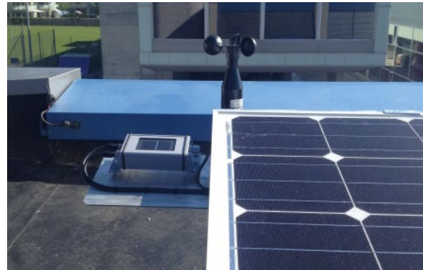
Abb. 3: Photovoltaik Anlage Erlen
