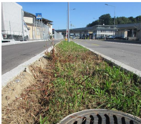
Grünstreifen mit Retention, Allmendstrasse, Zürich
