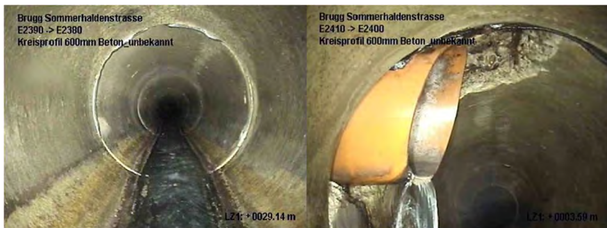
Abbildung 22; Fotos aus Kanalfernseh-Aufnahmen
