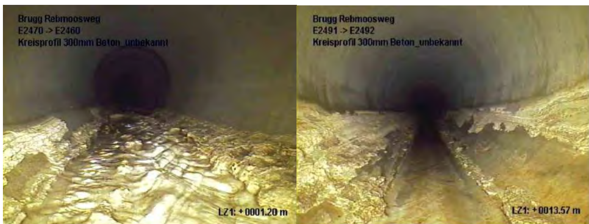
Abbildung 20; Fotos aus Kanalfernseh-Aufnahmen
