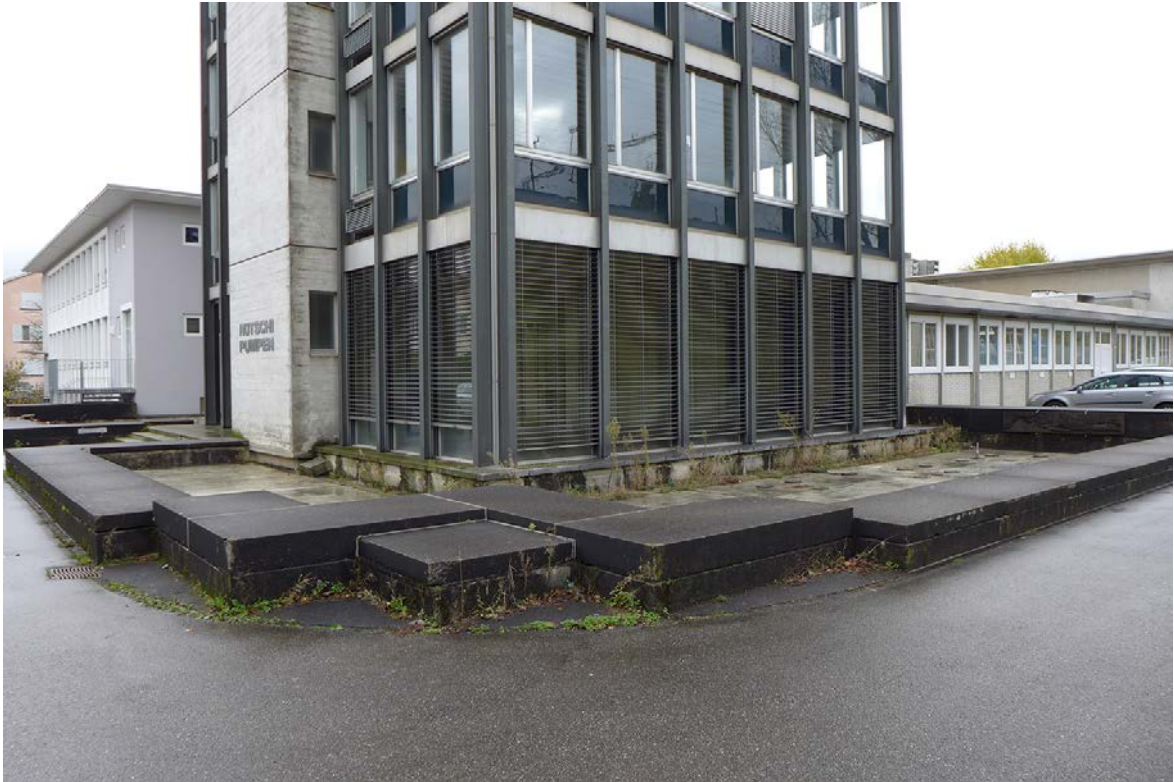
Abb. 30: «Rütschi-Tower» Zustand Wasserbassin. (Fabian Furter 2016)
