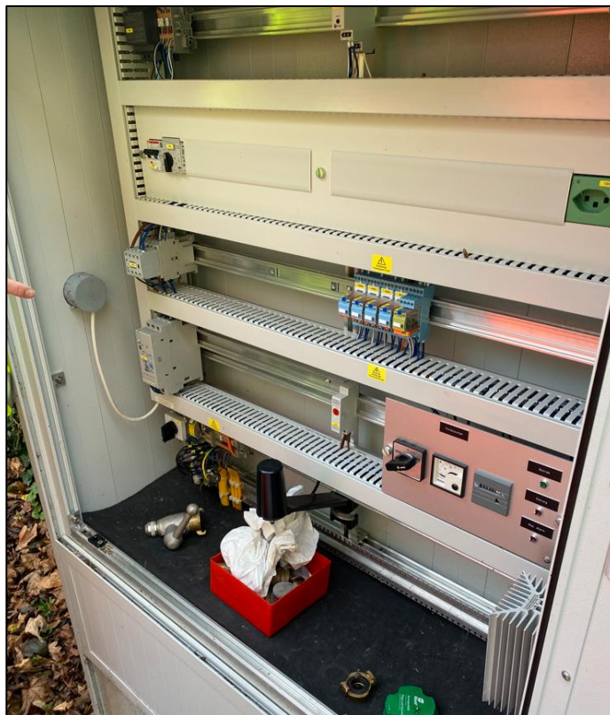
Abbildung 10: Ansicht Steuerungstechnik in der Aussenkabine
