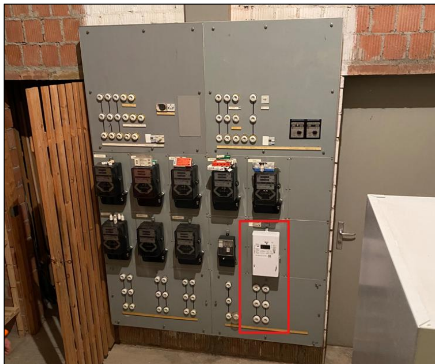
Abbildung 9: Messung EVU und Vorsicherung im Schacht der angrenzenden, privaten Liegenschaft
