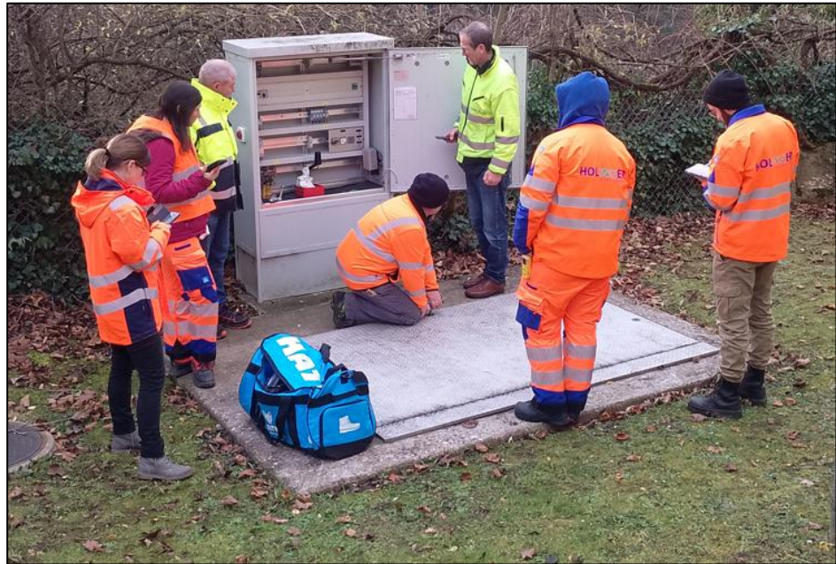
Abbildung 8: Steuerschrank direkt neben dem Pumpenschacht
