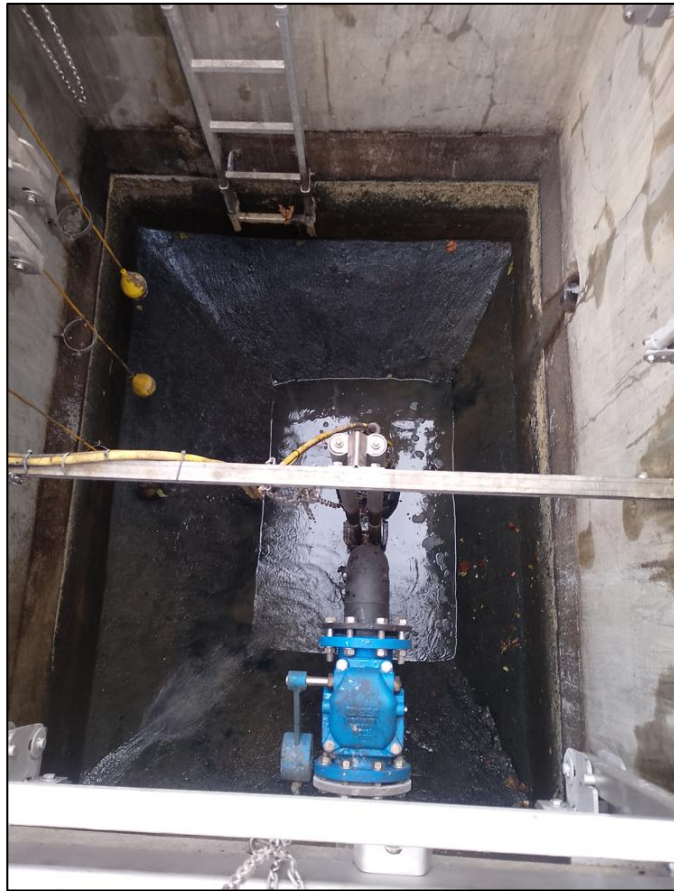
Abbildung 11: Pumpenschacht mit Pumpe und Schwimmerbirnen
