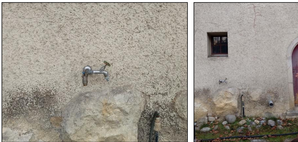
Abbildung 5: Trinkwasseranschluss an der Hauswand
