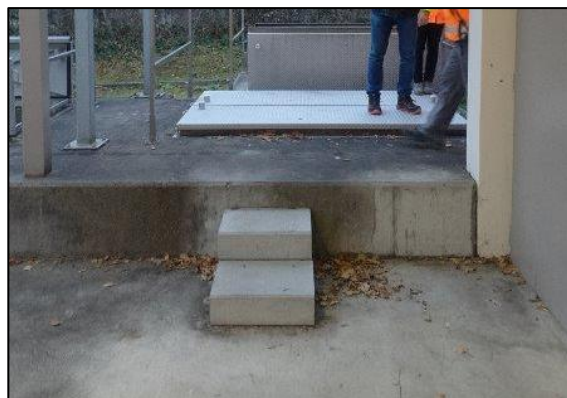
Abbildung 27: Erhöhung Sichtbarkeit Treppe durch ein gelb-schwarzes Warnband
