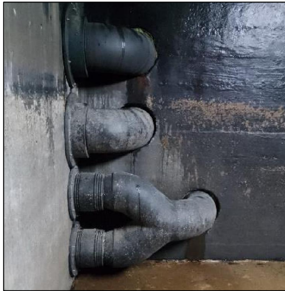
Abbildung 12: Druckleitungen aus dem Armaturenraum (links) zum Messschacht (geradeaus) und Zusammenführung der TW-Druckleitungen (unten)
