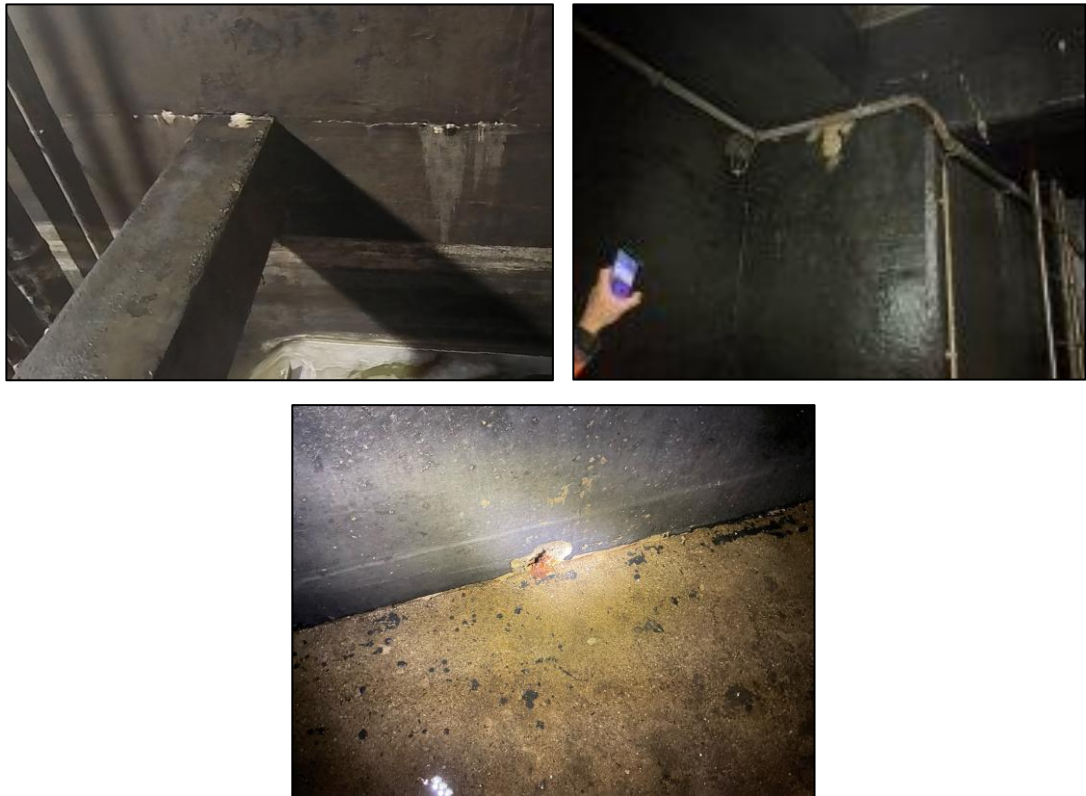
Abbildung 17: Risse über dem Kiesfang, Abplatzungen im Zulaufkanal
