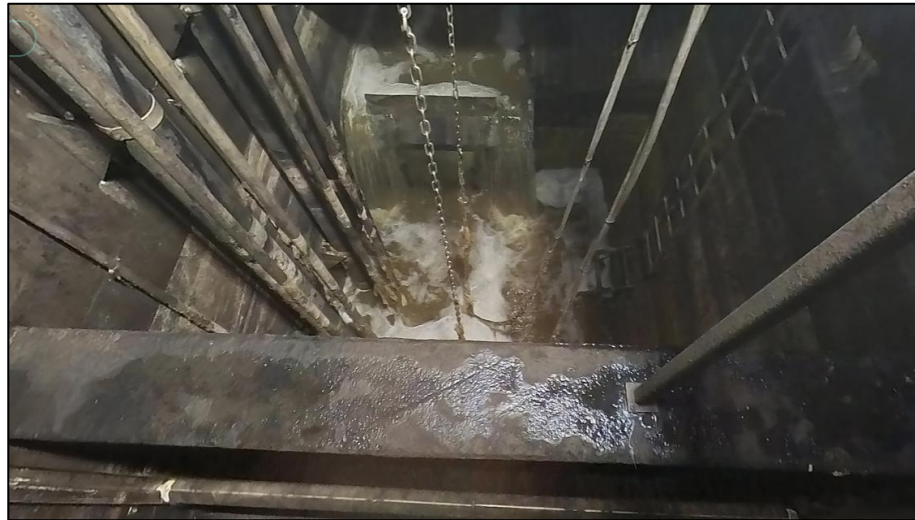
Abbildung 8: TW-Pumpensumpf (unten) und Kiesfang (oben)
