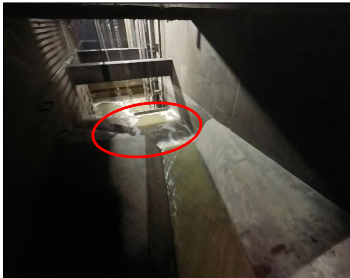
Abbildung 7: Kiesfang nach dem Zulaufkanal
