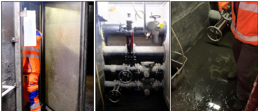
Abbildung 11: Armaturenraum mit Drucktür (links), Armaturen (Mitte) und nassem Boden (rechts)
