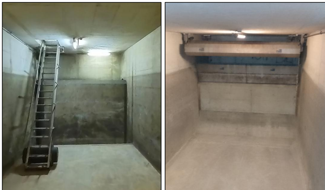
Abbildung 8: Einstiegstreppe, Zulaufkante und Entwässerungsrinne (links), Spülkippe, Tauchwand und Durchlaufbecken (rechts)
