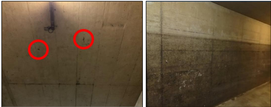
Abbildung 14: Korrodierte Stellen an der Decke (links), Wand des DB (rechts)
