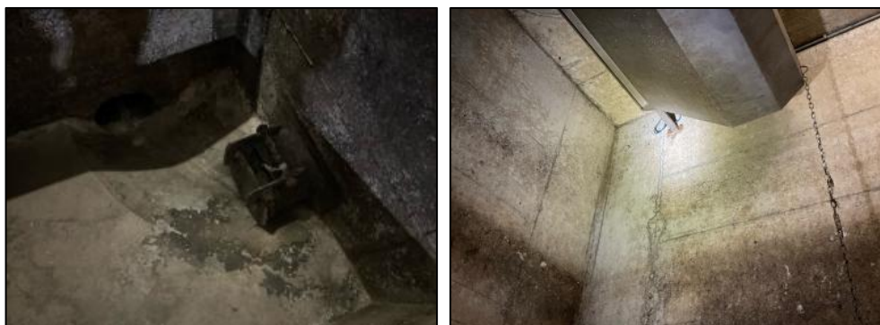
Abbildung 15: Rückschlagklappe vom DB ins FB (links), korrodierte Halterung der Spülkippe (rechts)
