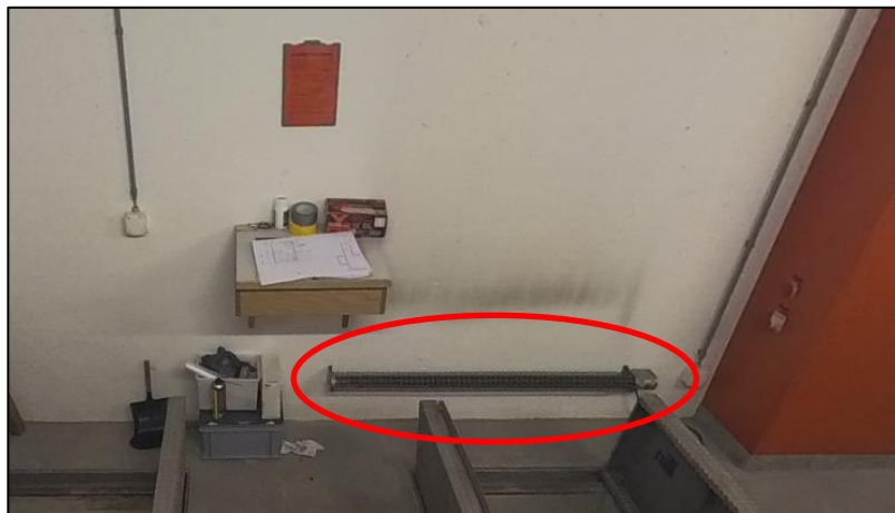
Abbildung 17: Heizung im Betriebsraum
