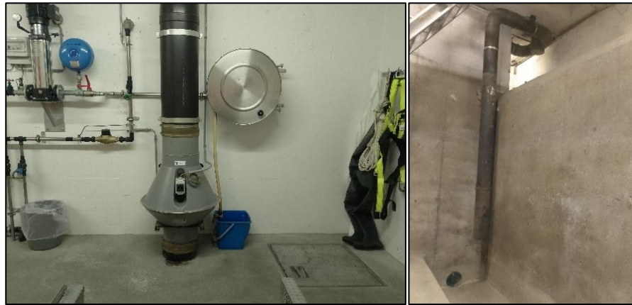
Abbildung 18: Ventilator (links) und Lüftungsrohr im Durchlaufbecken (rechts)
