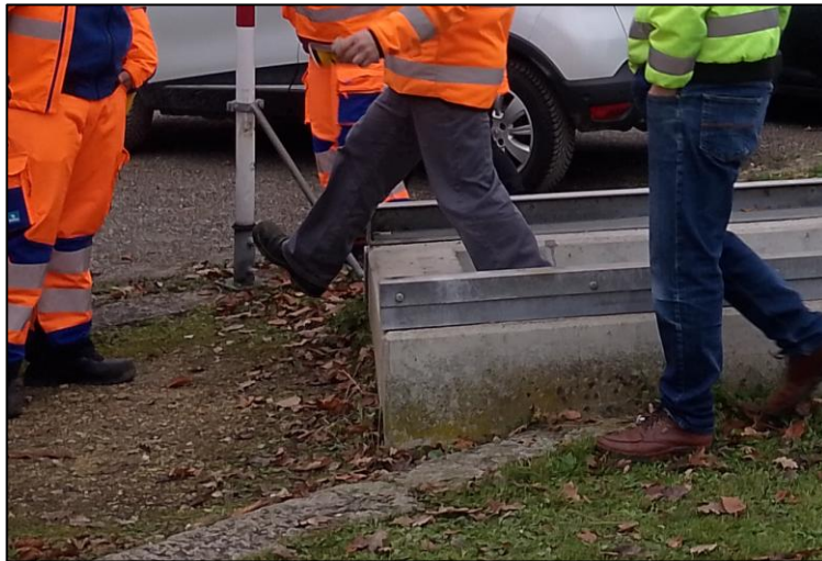
Abbildung 22: Der erste Tritt der Treppe ist zu hoch
