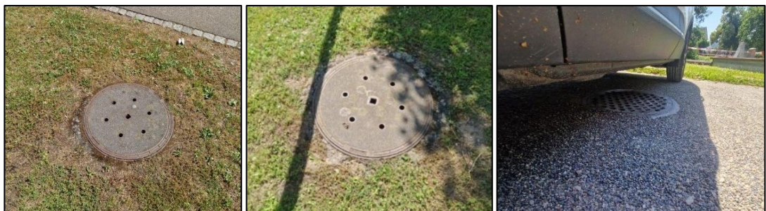
Abbildung 13: Von links nach rechts: Schacht zum DB (Zuluft + Einstieg), Schacht zum FB (Zuluft), Lüftungsschacht Parkplatz (Fortluft)
