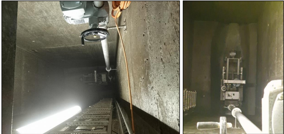
Abbildung 5: Drosselschacht mit Waagedrossel nach dem Auslauf
