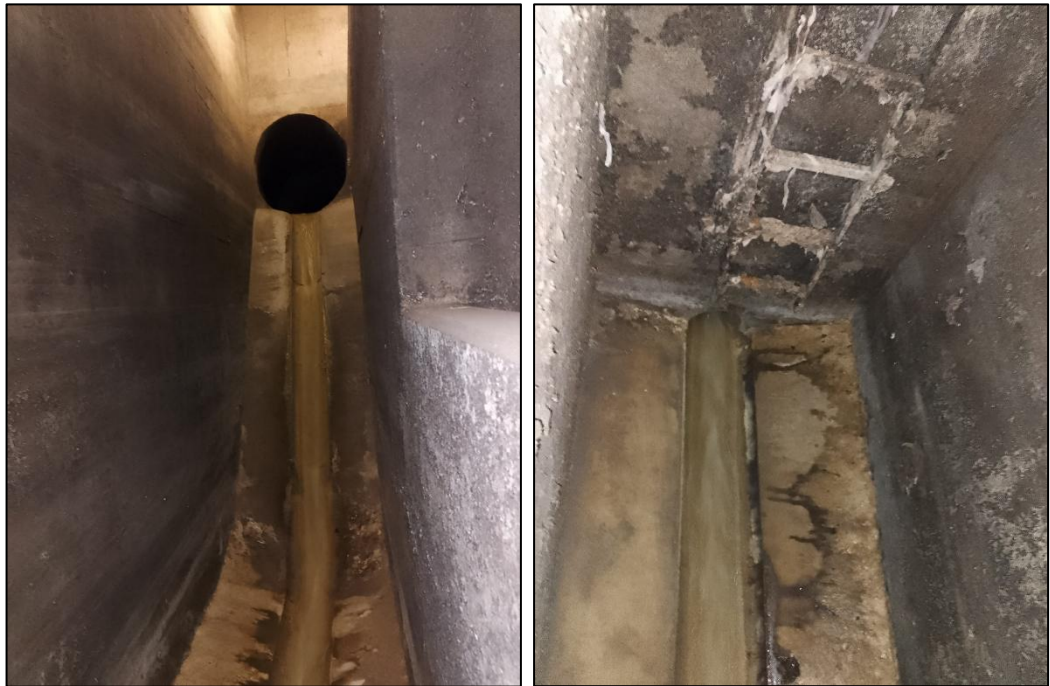
Abbildung 3: Zulauf (links) und Auslauf (rechts)
