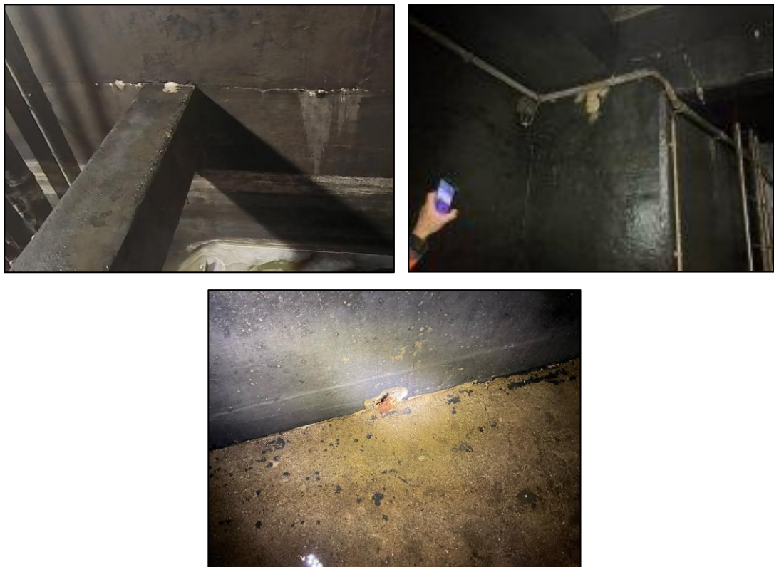
Abbildung 17: Risse über dem Kiesfang, Abplatzungen im Zulaufkanal
