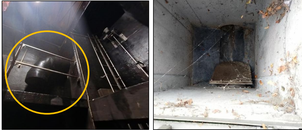
Abbildung 10: Notentlastungsrohr im Pumpwerk (links) und Rückschlagklappe vor dem Süssbachkanal (rechts)
