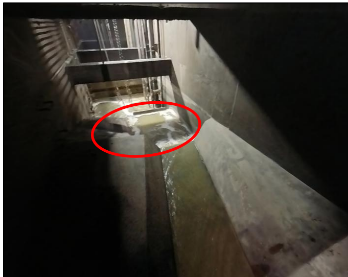
Abbildung 7: Kiesfang nach dem Zulaufkanal
