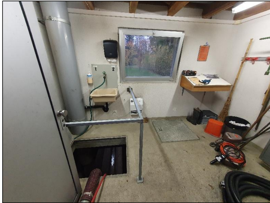
Abbildung 15: Abdeckungen, Lavabo und Stehtisch im Betriebsraum
