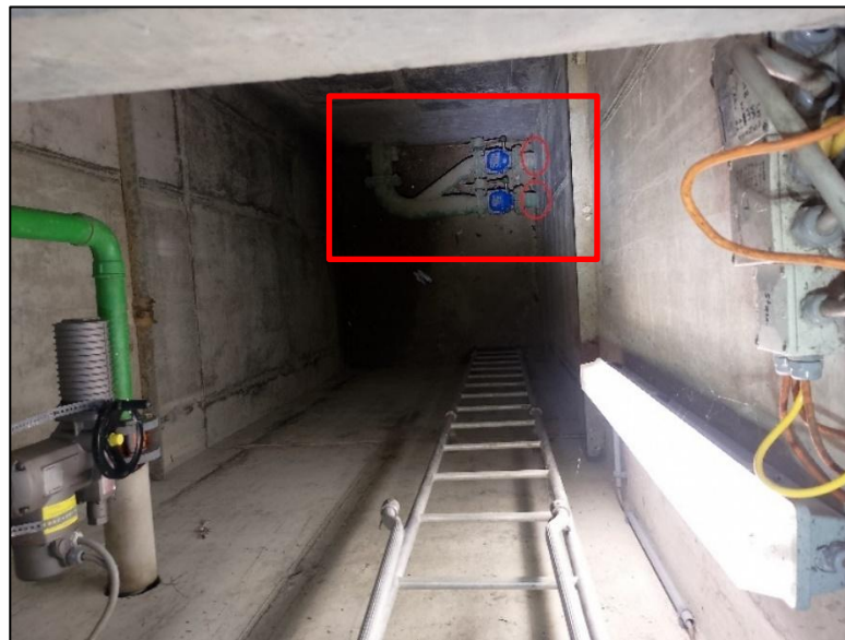
Abbildung 5: Blick in den Armaturenschacht
