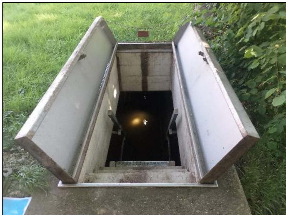
Abbildung 22: Abdeckung, Zugang zum Becken
