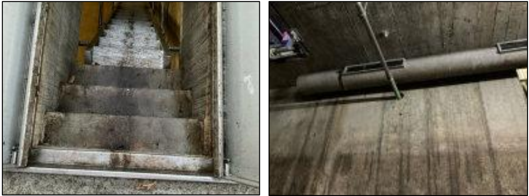
Abbildung 8: Einstiegstreppe (links) Durchlassloch in der Wand (rechts)
