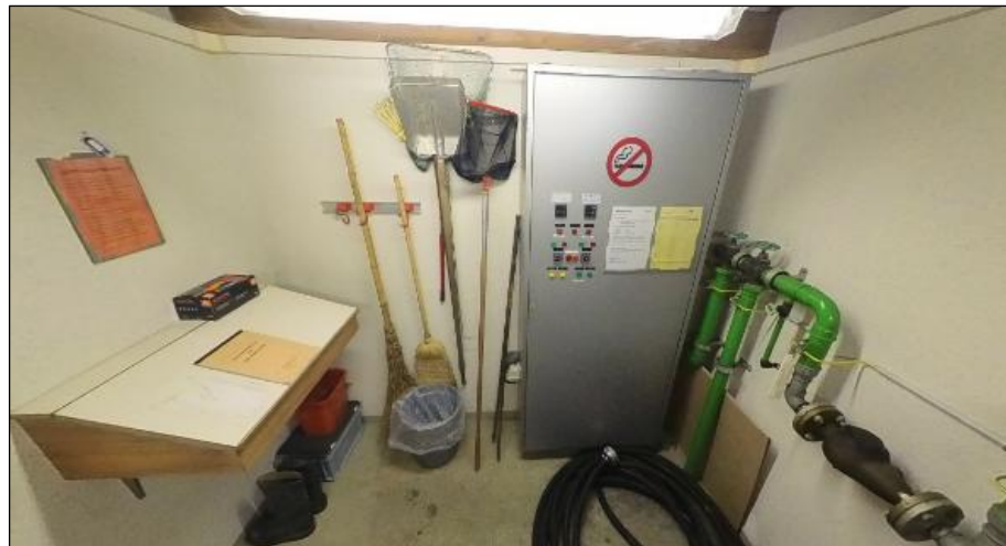
Abbildung 10: Betriebsgebäude: Schaltschrank, Trinkwasserleitungen und Büro
