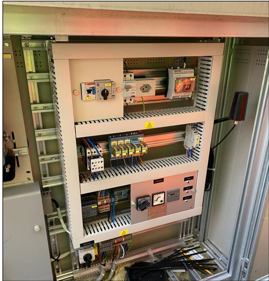
Abbildung 7: Ansicht Steuerungstechnik in der Aussenkabine
