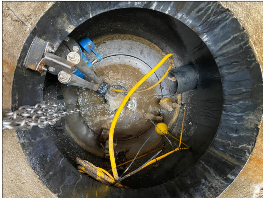
Abbildung 8: Pumpenschacht mit Pumpe und Schwimmerbirnen
