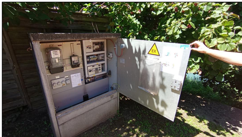
Abbildung 5: Steuerschrank direkt neben dem Pumpenschacht
