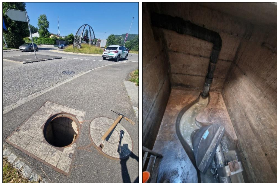
Abbildung 5: Drosselschacht von aussen (links) und von innen (rechts)
