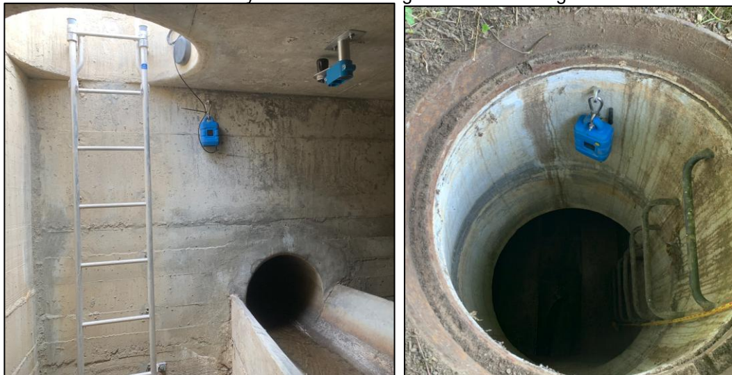
Abbildung 13: Beispiel einer Niveaumessung Entlastung und autarker Messkoffer mit Batterie
