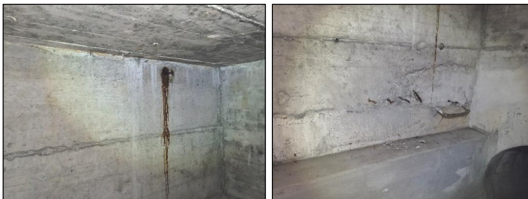
Abbildung 5: Korrosion am Beton
