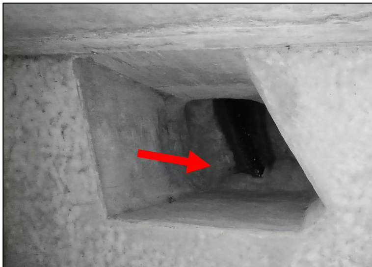
Abbildung 7: Unbekannter Einlauf einer Leitung in den Entlastungskanal
