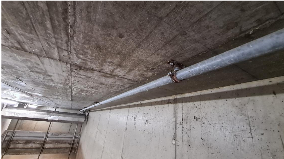
Abbildung 9: Korrodierte Halterungen bei Wasserleitung zur Spülkippe
