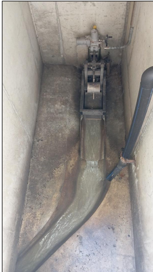
Abbildung 4: Drosselschacht mit Drossel und Handschieber
