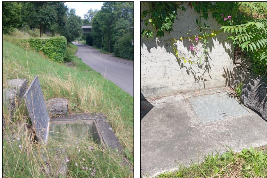
Abbildung 12: Abdeckung im Aussenbereich über dem Überlauf(rechts) und über dem Drosselschacht (links)
