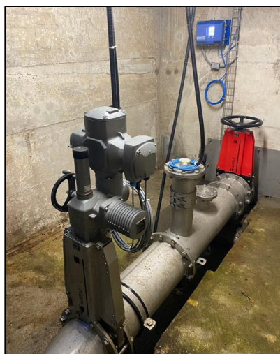
Abbildung 14: Beispiel Abflussregulierung vom FK Risi in Windisch
